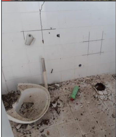
▲ Portão e interior da unidade foram destruídos por vândalos; local está entregue aos meliantes
