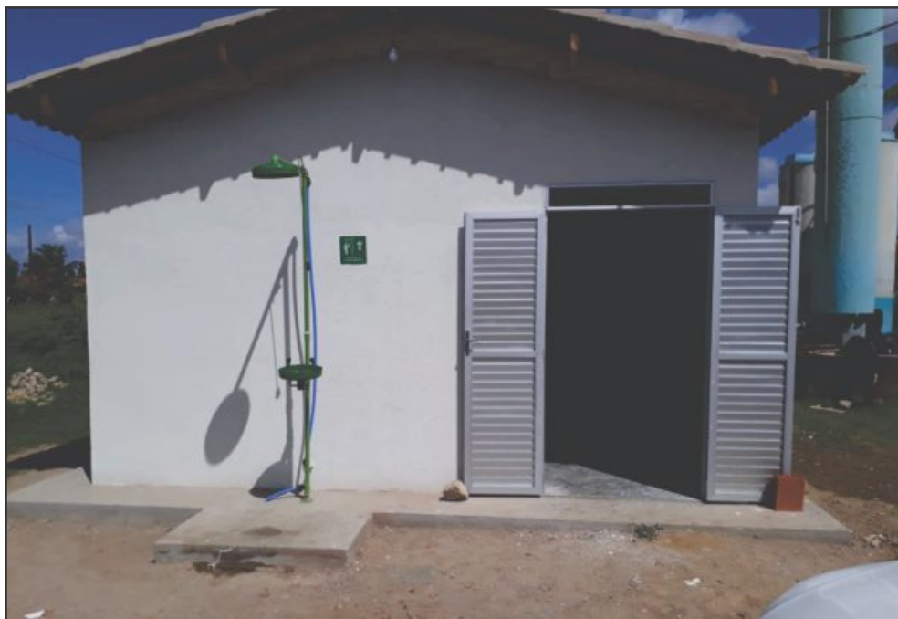
▲ ETA não foi finalizada e o todo o material acaba ficando exposto à própria sorte
