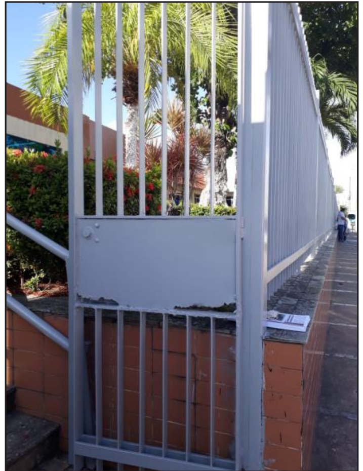
▲ Pintura do portão foi feita sem se quer recuperar a parte corroída
