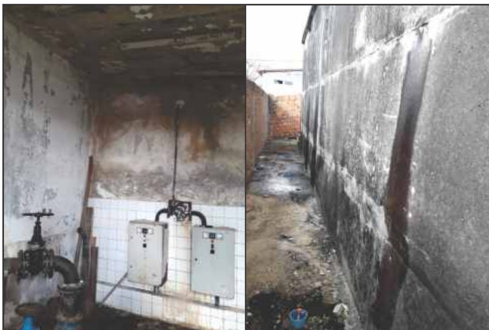
▲ Teto corroído e quase desabando, além de rachaduras e vazamentos comprometem o reservatório
