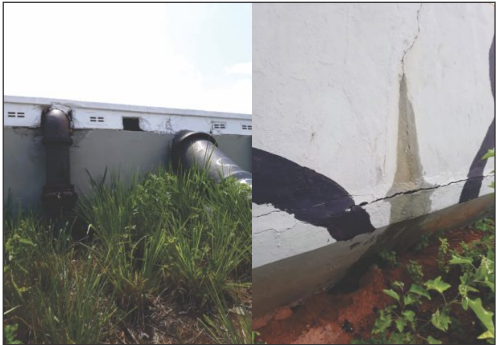
▲ DESCASO Mato tomando conta e a rachadura que rendeu manchetes na imprensa local
