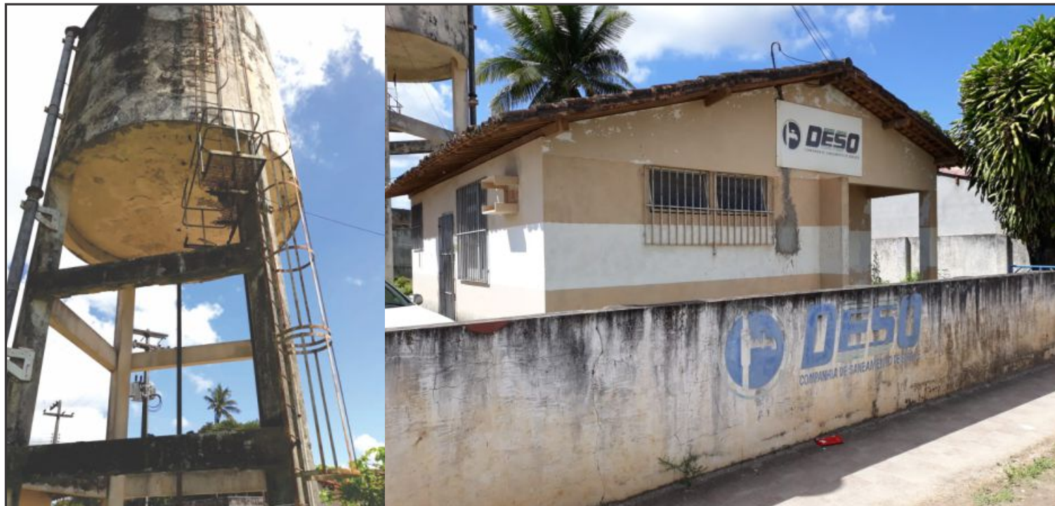
▲ Reservatório de Campo do Brito com estrutura completamente corroída e a Loja de Atendimento com a aparência de abandono total
